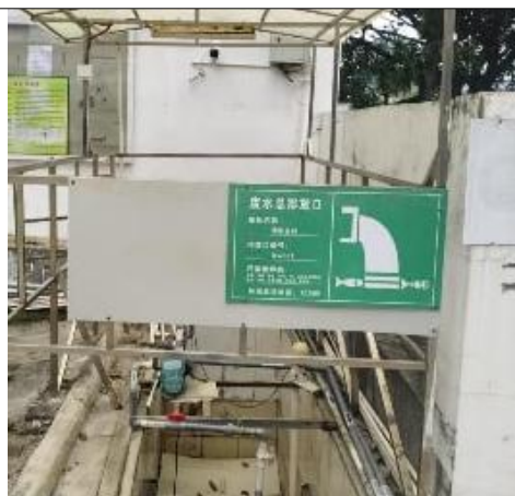
生产废水总排口（DW001）
